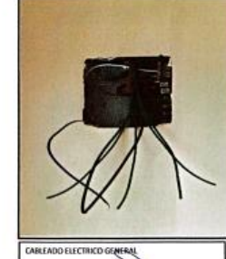
CABLEADO ELECTRICO GENERAL
